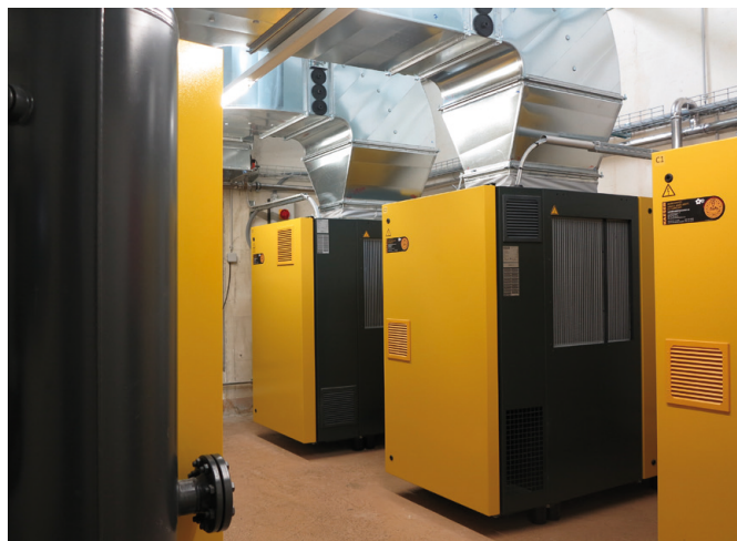
La nouvelle salle des compresseurs
